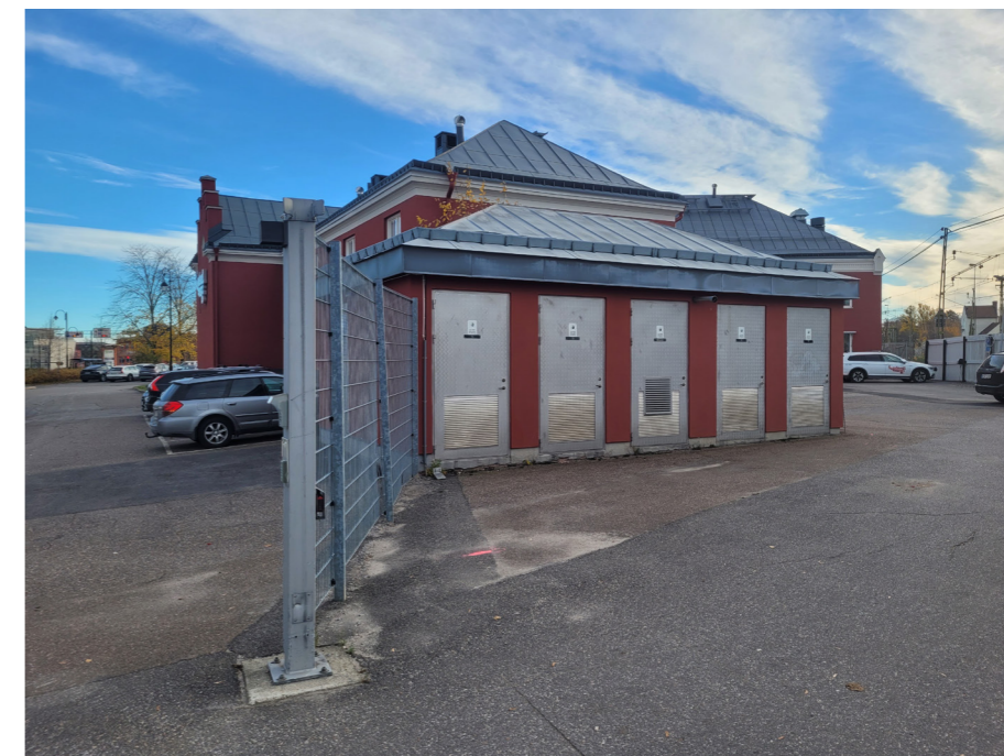
Transformatorstationen med galvade dörrar mot väster.
